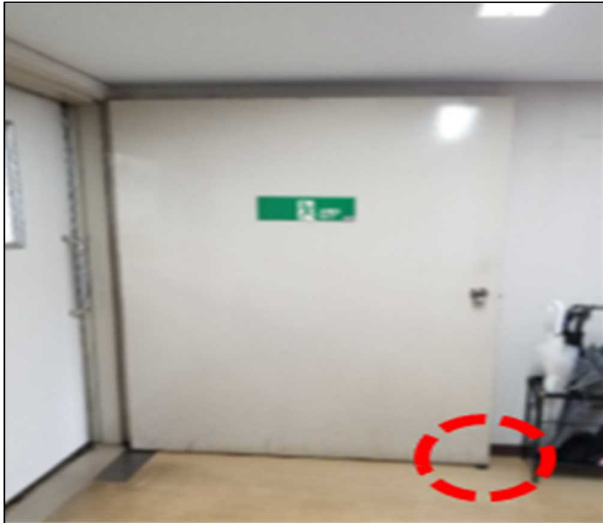
常時解放された防火扉
