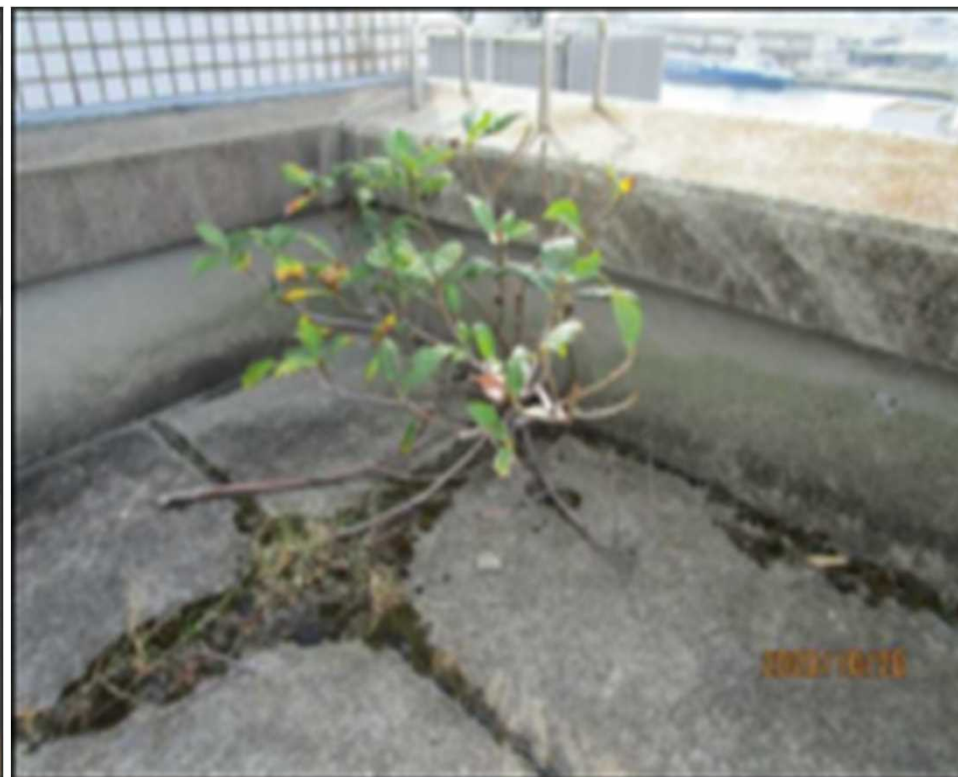
伸縮目地に繁茂 した植物
