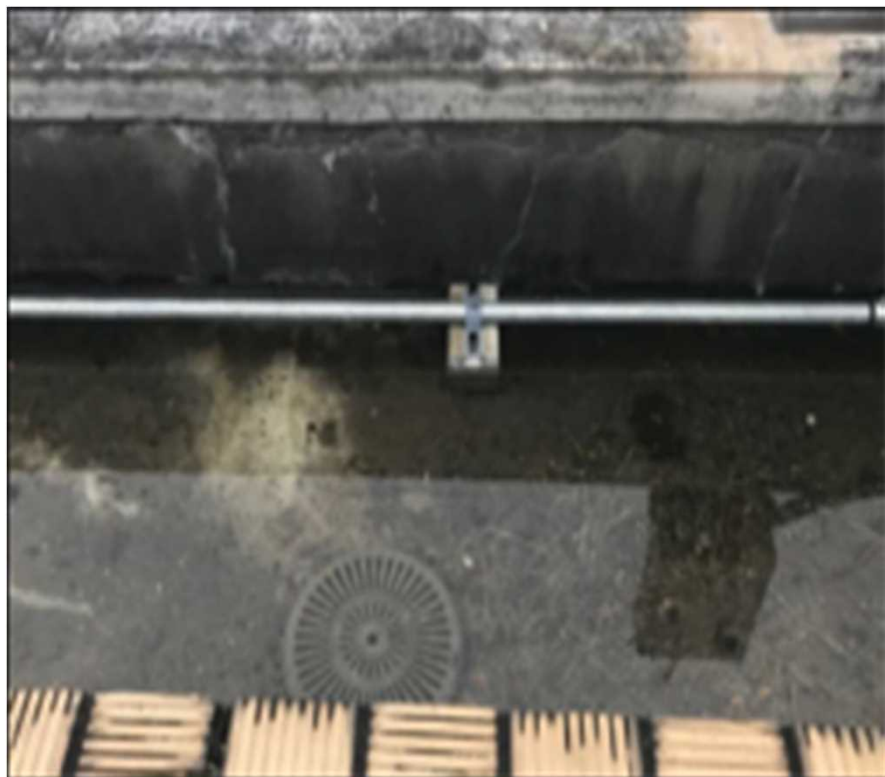
排水不良による 水たまり
