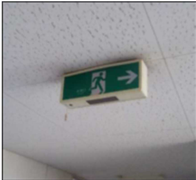
点灯しない誘導灯
